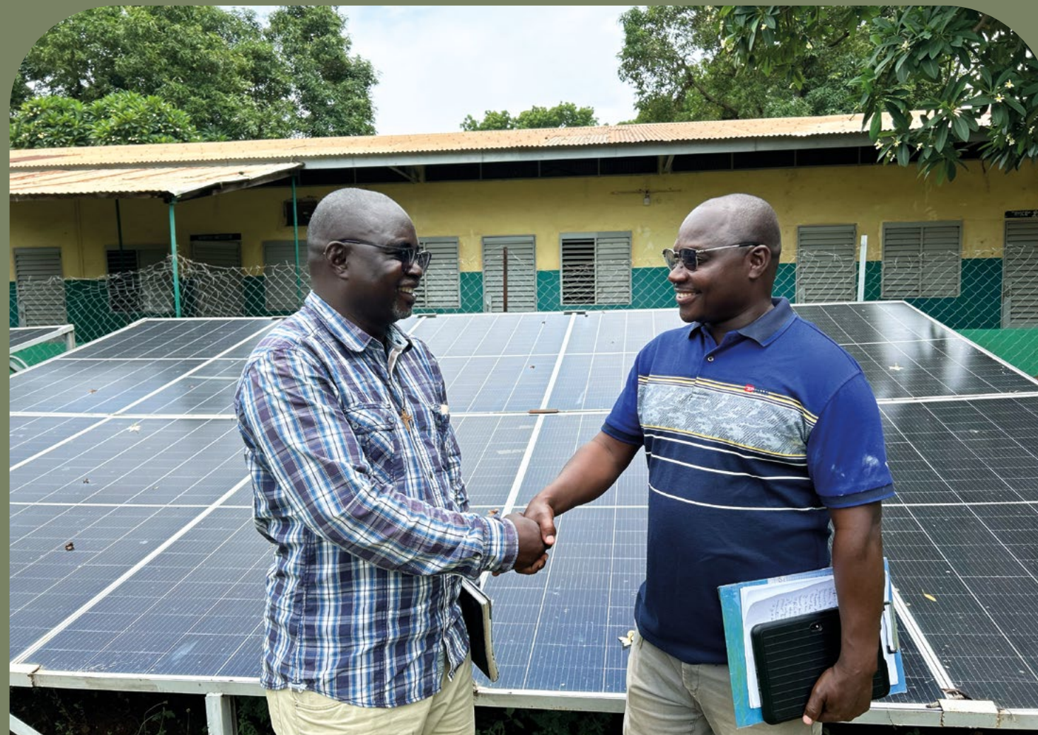
Elie, référent RSE Perenco de la zone, et Fidèle, entrepreneur soutenu par la Fondation, devant les installations solaires du laboratoire de l'hôpital de Moundou, à remettre en service - Tchad
